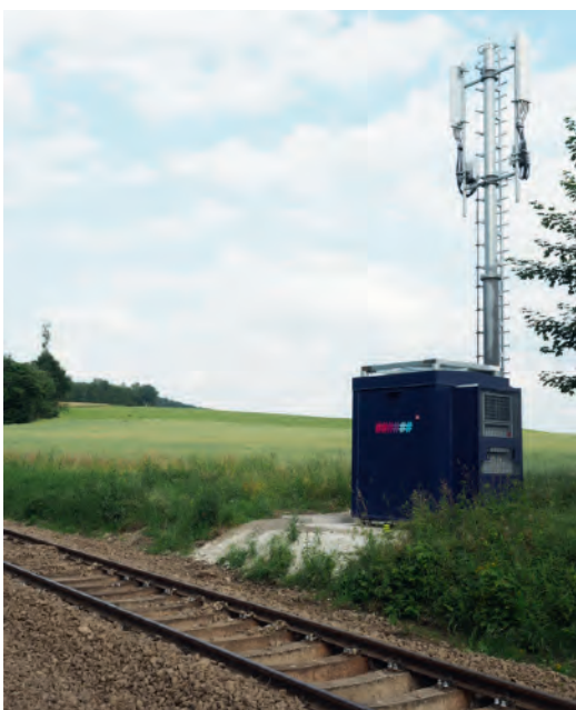
Bild 4: Funkinfrastruktur am Bhf. Markersbach
