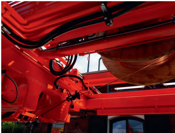
Abb. 7.27: Messsystem im Fahrdrachtzulauf
