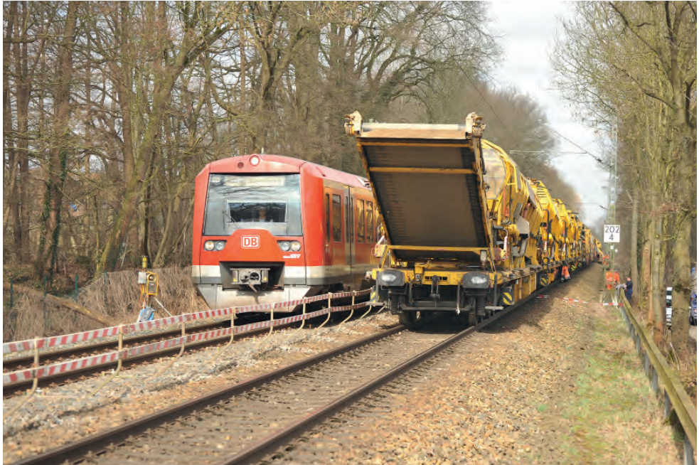
Abb. 8.4: Betrieb im Nachbargleis: Während die S-Bahn vorbeieilt, läuft im Baugeis die Materiallogistik für die Umbaumaschine. (Foto: Achim Uhlenhut)
