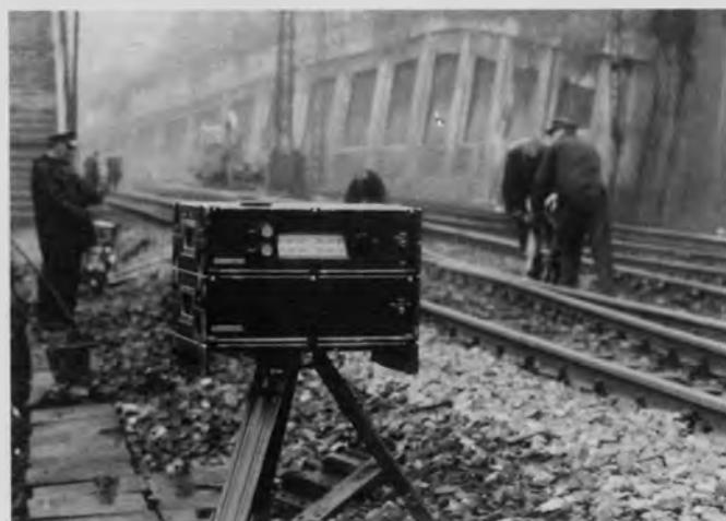
Bild 2: Zentrale des von AEG-Telefunken entwickelten Anrückmeldesystems, die unmittelbar bei dem für die Arbeitsrotte verantwortlichen Sicherheitsposten aufgestellt ist
